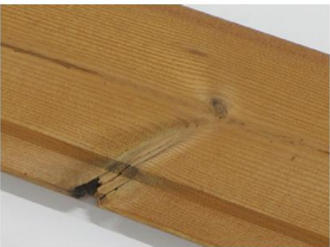
Neviditelné vady po instalaci jsou povoleny.
